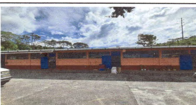
Foto 18. Pintura en muros exteriores del establecimiento.
